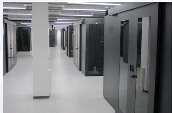
Mit dem Blauen Engel für energiebewussten Rechenzentrumsbetrieb ausgezeichnet: Das Secure Data Center des ITDZ Berlin / Foto: ITDZ Berlin
